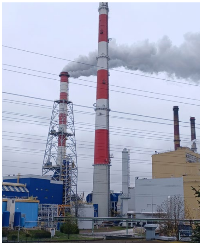
Nowa kotłownia rezerwowo-szczytowa w EC Gdańskiej - widok z zewnątrz
