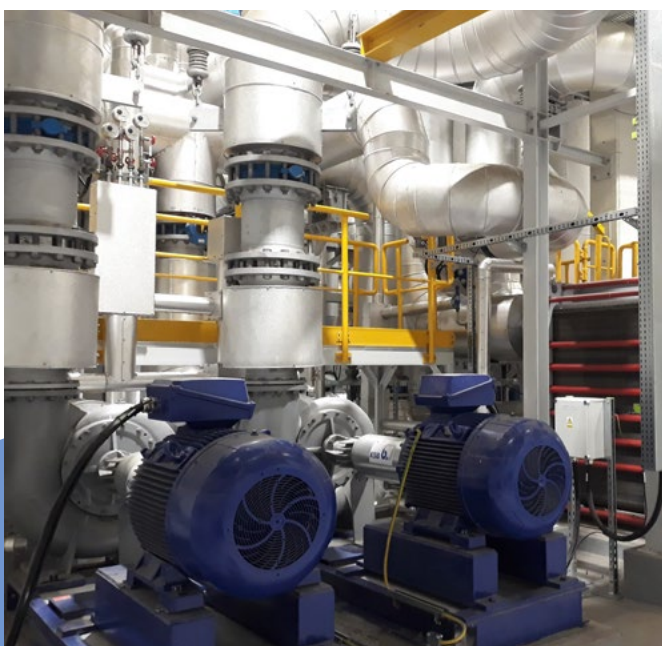
Nowa kotłownia rezerwowo-szczytowa w EC Gdańskiej
