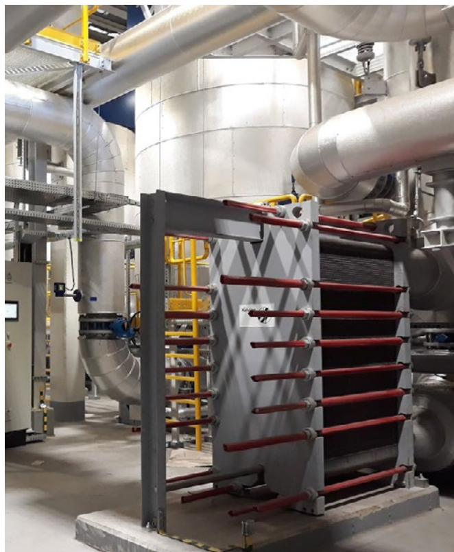
Nowa kotłownia rezerwowo-szczytowa w EC Gdańskiej - widok wewnątrz
