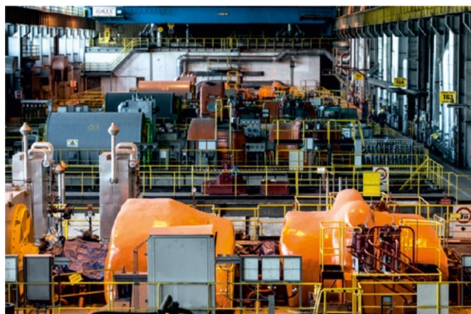
Hala maszynowni w Elektrociepłowni Gdańskiej
